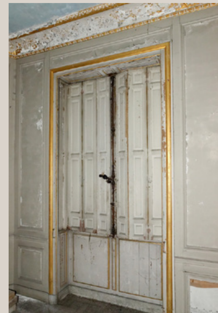
Vue des dégradations dans un des salons du premier étage.
