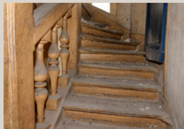
Escalier en bois milieu XVII e siècle, détail d'un palier desservant les niveaux adjoints ultérieurement.
