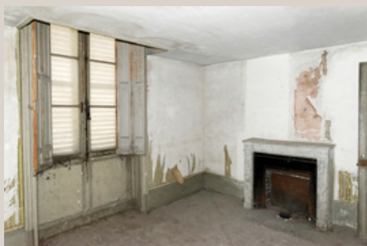
Vues des dégradations dans les pièces du premier étage.
